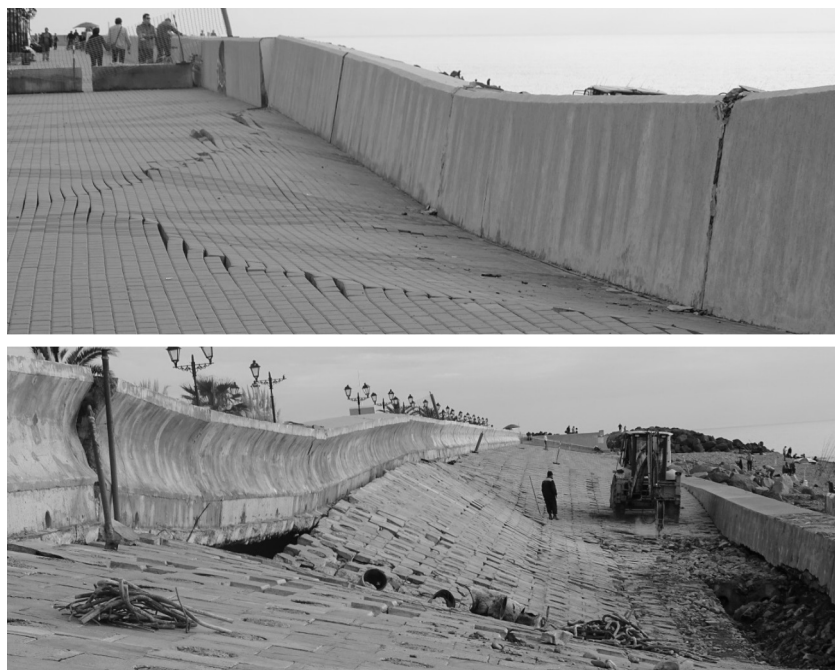
Рис. 2. Деформации парапета и набережной. Ноябрь 2017 г.
